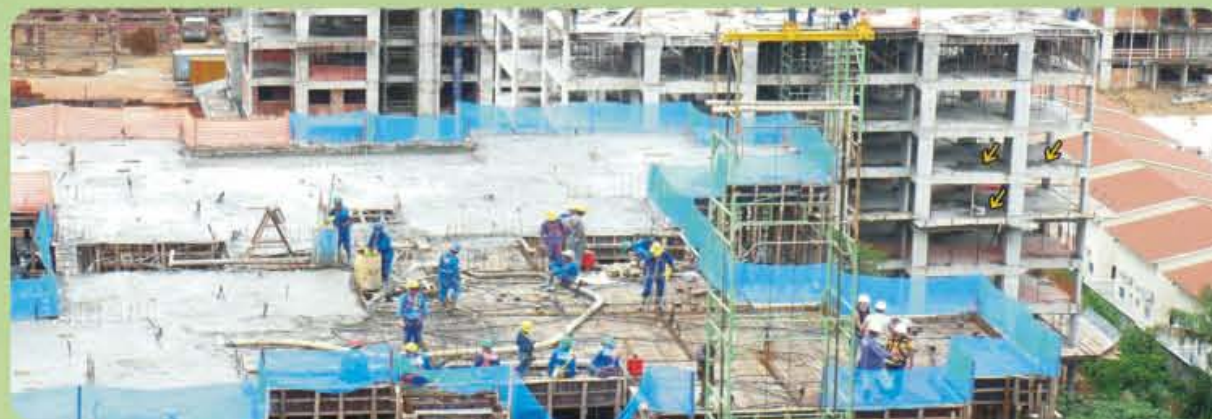
Figura 1. Aspecto geral das construções. As setas em amarelo apontam os locais com água acumulada nas lajes.
