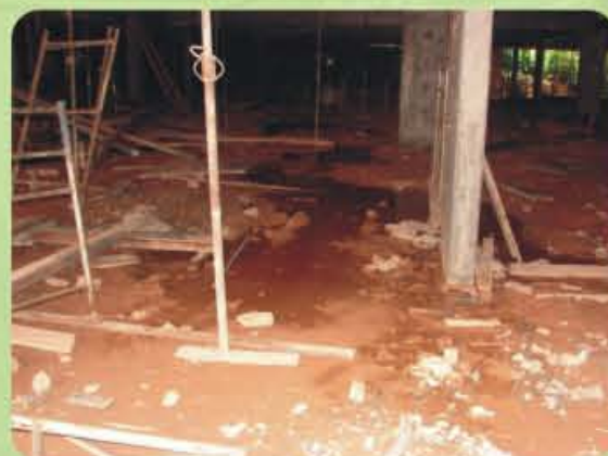
Figura 2. Condições de áreas alagadas no andar térreo.
